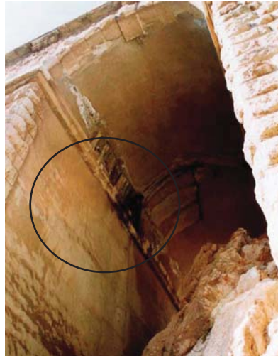
Intradós de uno de los dos arcos del puente de Córdoba que muestra filtraciones de agua a nivel de los riñones.
