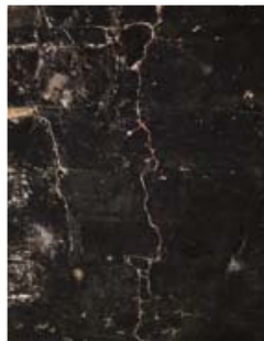
Figura 6. Fisuras y grietas dentro de la bóveda 1 Fuente: Autoras
