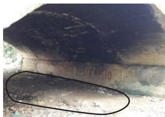
Figura 7 Presencia de grafitis y residuos de quema en la bóveda # 1 del puente Los Libertadores. Fuente: autoras
