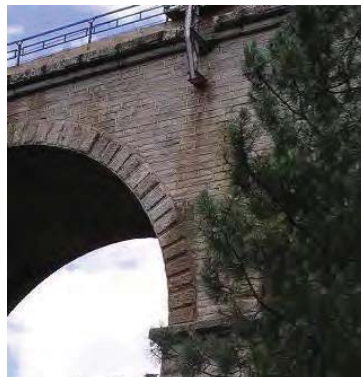
Manchas en tímpano por lixiviación de elementos de hierro en poste de catenaria, líneas de escorrentía.
