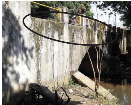
Figura 5. Presencia de vegetación, causa de humedad por escorrentía. Fuente: Autoras
