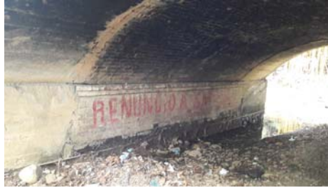
Figura 9. Presencia de grafitis y residuos de quema en la bóveda # 2 del puente Los Libertadores.
