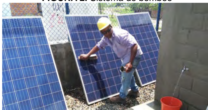
FIGURA 2. Sistema de bombeo
