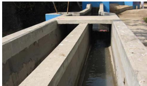
Imagen N° 2: Cámara de desarenador
