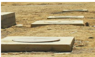
Fotografía N° 7: Buzones de la PTAR
