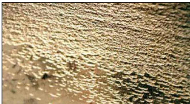
Imagen 4. Superficie dañada por un proceso de FAC de una fase. Se pueden observar las señales en forma de escamas o piel de naranja que caracteriza la superficie. ( Field Guide FAC and erosion ". EPRI [13])
