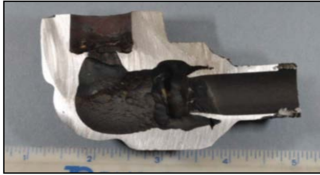
Imagen 3. Conexión en codo soldada, que presenta la superficie interna dañada por FAC y desgaste. También se aprecia la disminución del espesor del codo. (Field Guide FAC and erosion. EPRI [13])
