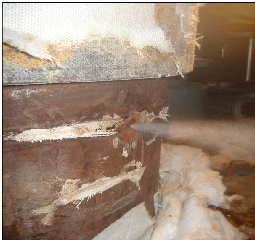
Imagen 1. Punto de fuga de vapor, debido a la pérdida de espesor en zona afectada por la soldadura (imagen cedida por Nuclenor)
