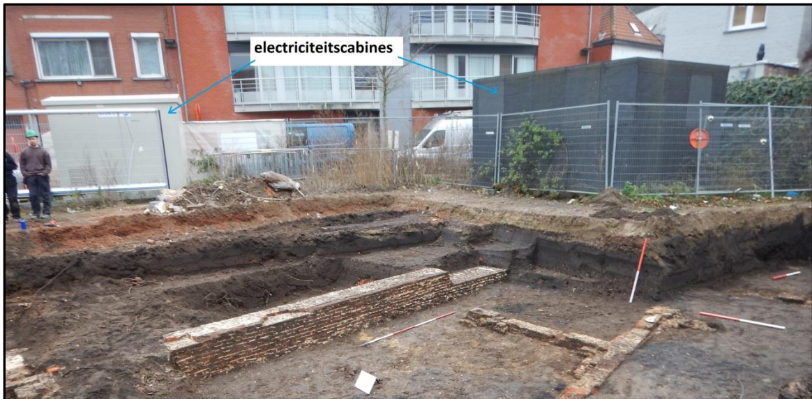
Figuur 7: Electriciteitscabines langs de Van Busleydenstraat
