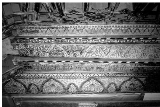
Figura 8 Arrocabe de la armadura del Antoratorio. Se aprecian los desajustes entre las distintas piezas que lo conforman
