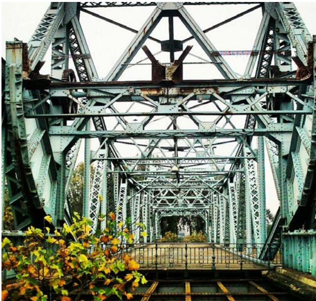
Figura 9. Vista de los restos del puente en su ubicación actual.
