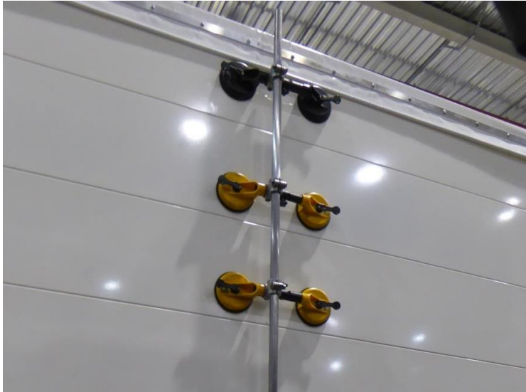
Imagen 6: Sistema de fijación del anemómetro actual
