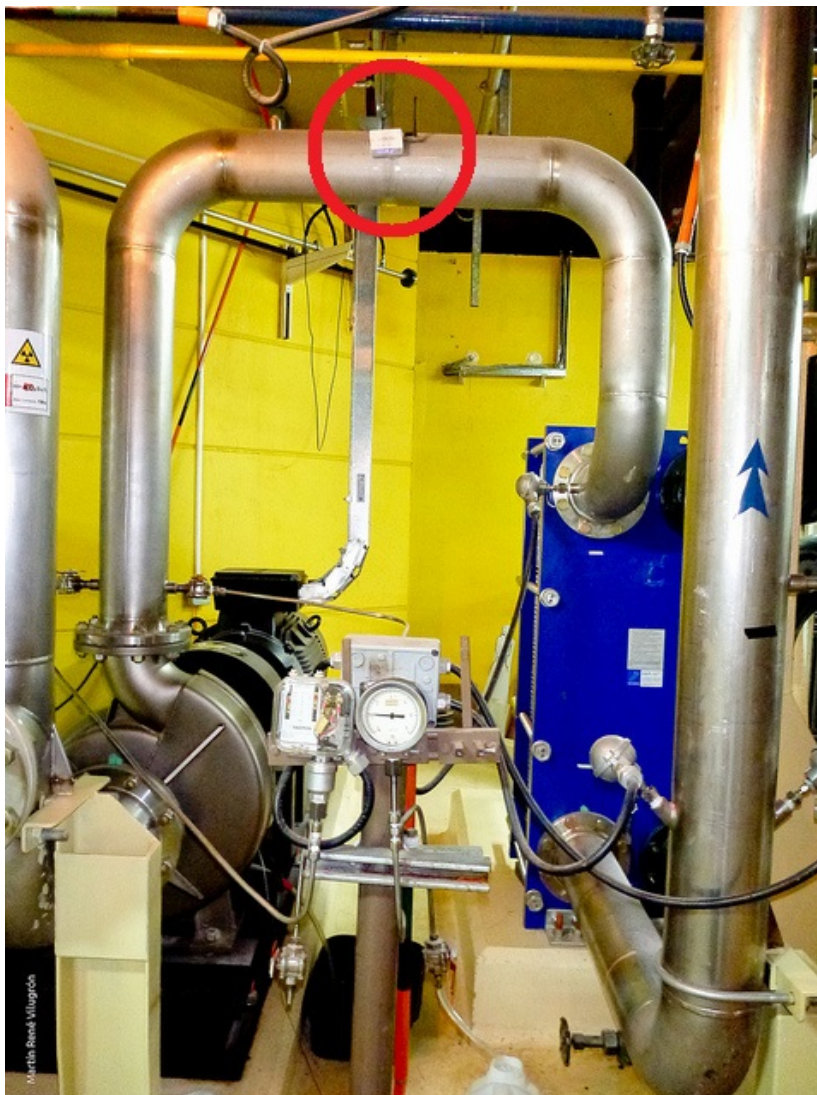
Figura 3.1: Medición de vibración en el caño de salida de la bomba del primario.
