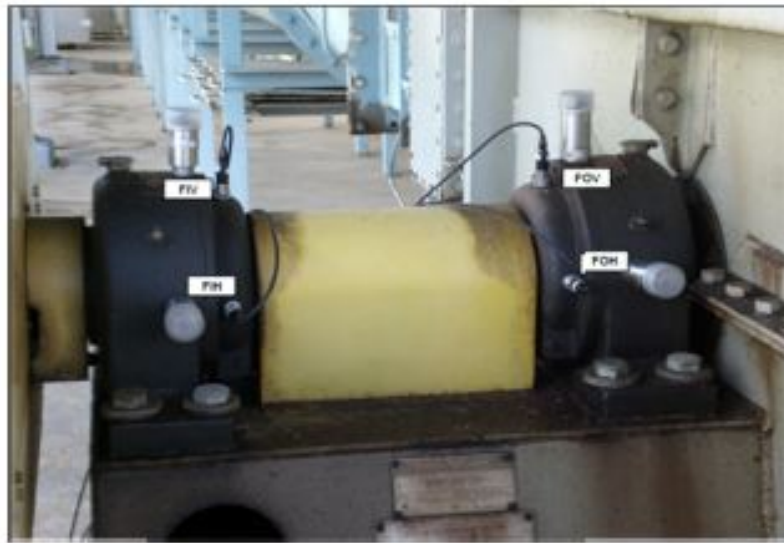
Figura 6.8: Motor donde se mide vibración en Central nuclear Comanche Peak.
