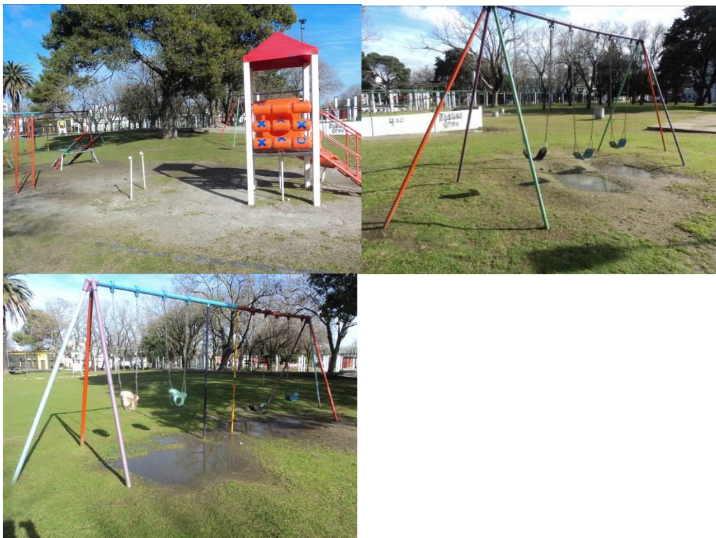
Figura 19: Plaza Irigoyen: se puede observar a la izquierda un dispositivo lúdico integrado en estado Malo por ausencia de puente, barandas y tobogán.
