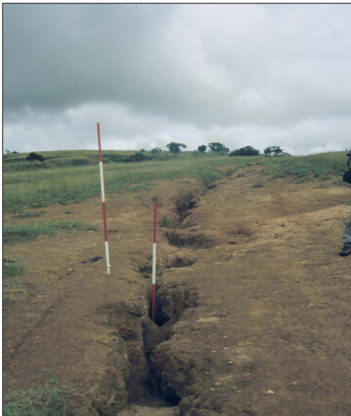
Abbildung 2.6: Durch Interrill-Rill Erosion stark degradierte Fläche im oberen Mbuluzi Einzugsgebiet (Swaziland). Die hier gezeigten Formen sind teilweise bereits nicht mehr reversibel und können als Übergangsstadium zur Gullyerosion bezeichnet werden. Messstäbe mit 50cm Markierung (Photo: Märker)
