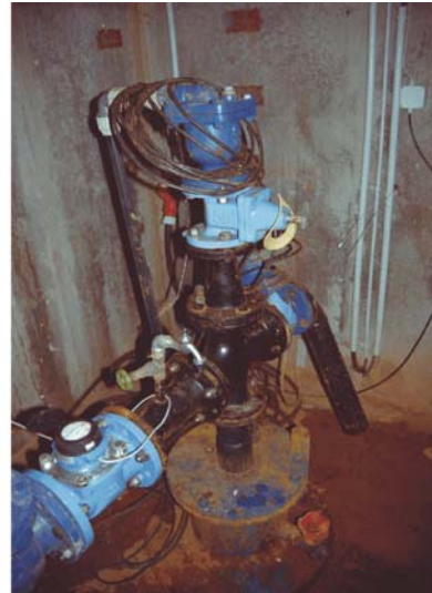
Brunnenstube TB Geisenhain Sta 3/78
