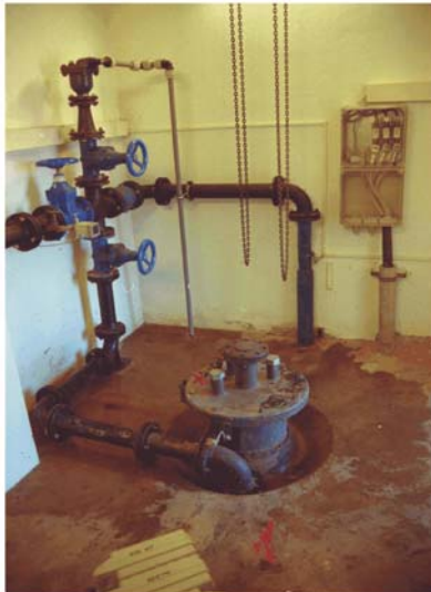
Brunnenstube TB Jägersdorf Jaef 1E/80
