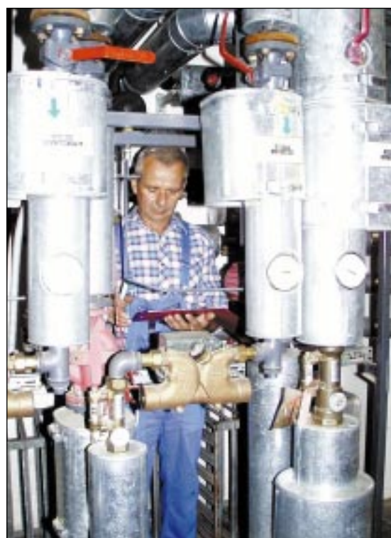
Abb. 11: Ablesen der Verbrauchswerte Fernwärme
