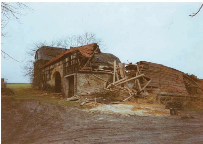
Der stetige Verfall zog zwangsläufig den Totalabbruch 1997 nach sich.
