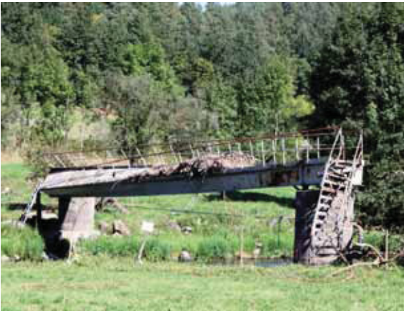
Von der Elster verursachte Hochwasserschäden an der Clodramühle
