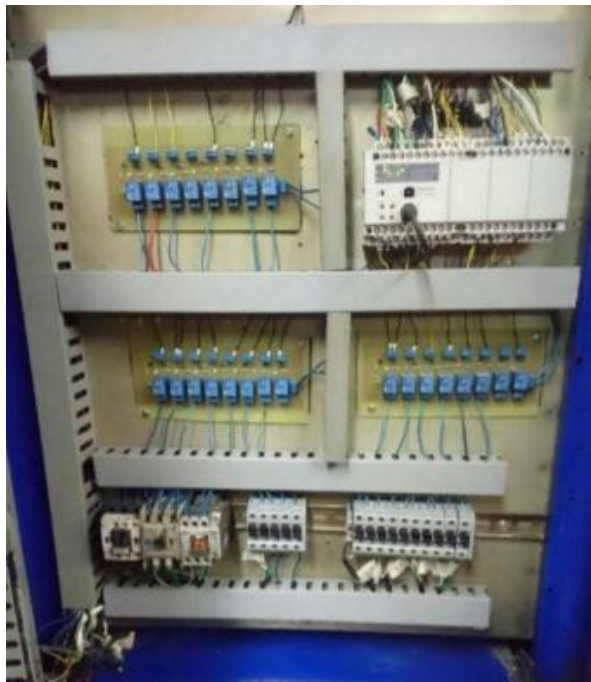
Figura 2. 9 Tablero de Control MIR 65
