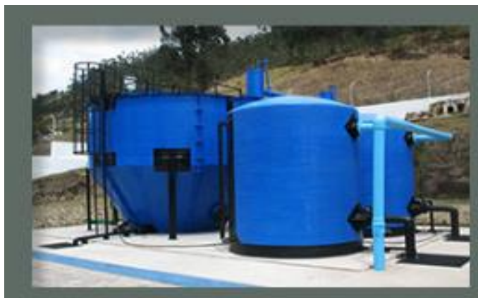
Fig. 29. Planta de Tratamiento Semi Compacta (PURIPACK-2)
