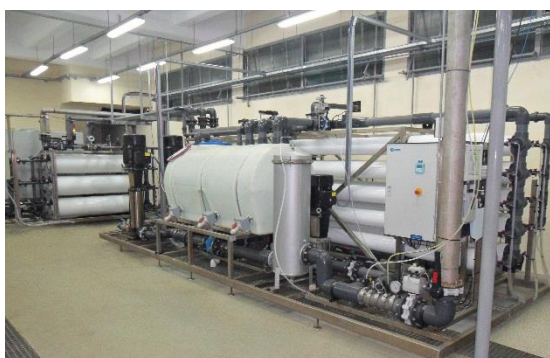
Figura 2 Sistema de filtración [3]
