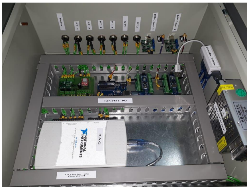
Figura 31 Tablero de control
