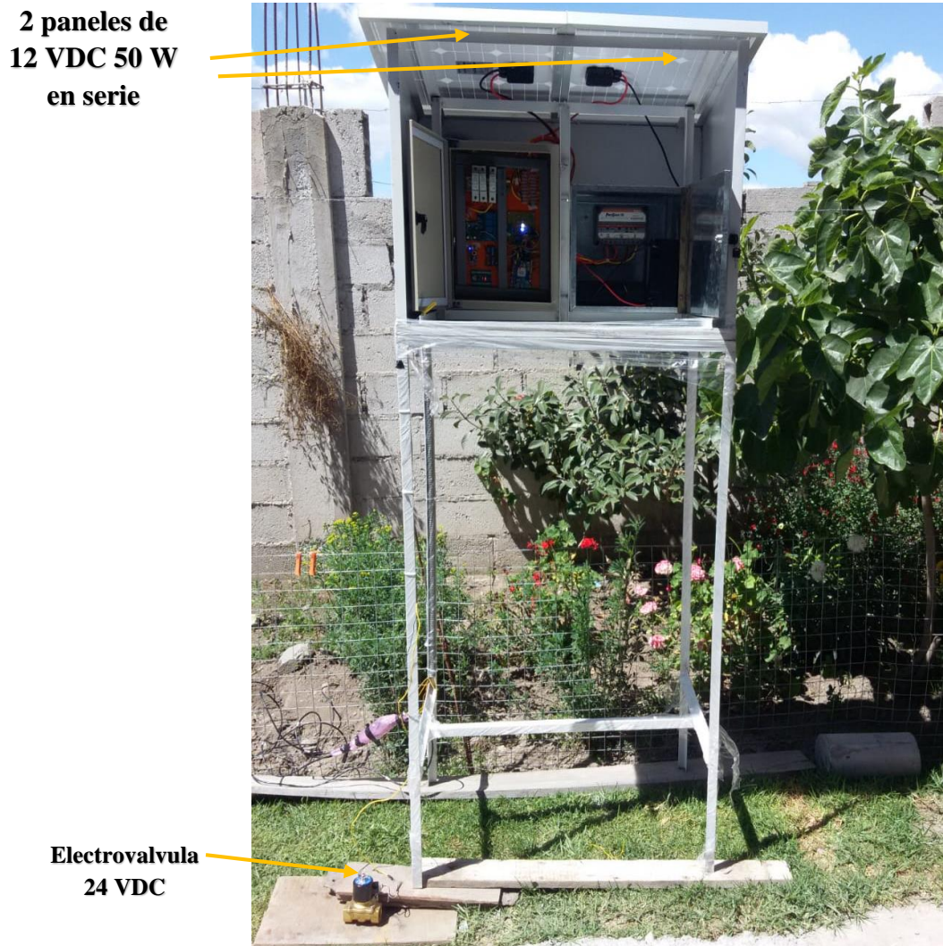
Figura 4.4. Implementación de estructura mecánica y electrónica.
