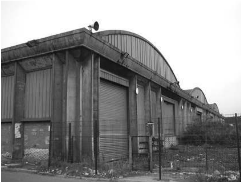
Figure 4 (a et b). Les halles à trafic accéléré de Pantin, Bernard Lafaille, ingénieur, 1946-1947.
