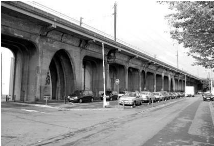
Figure 12a. Estacade de la ligne complémentaire de la Grande Ceinture à Neuilly-sur-Marne entre le boulevard du Maréchal Foch et la Marne.
