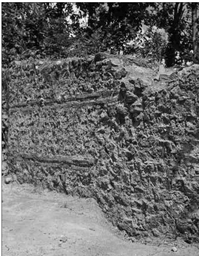
Figure 17 : Face interne du mur extérieur oriental montrant la réfection à arases de briques (phase IV) qui s'appuie sur le mur antérieur (phase III). Les joints tirés au fer entre les moellons de schiste sont bien visibles (Cl. J. Hyvert, 1979).
