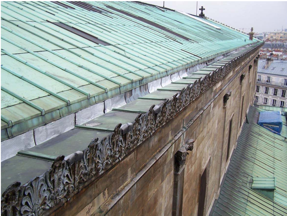
Saint-Vincent-de-Paul (10e arr.). Pansements de paxalu permettant la survie momentanée des chéneaux. Phot. Laurence Fouqueray.
