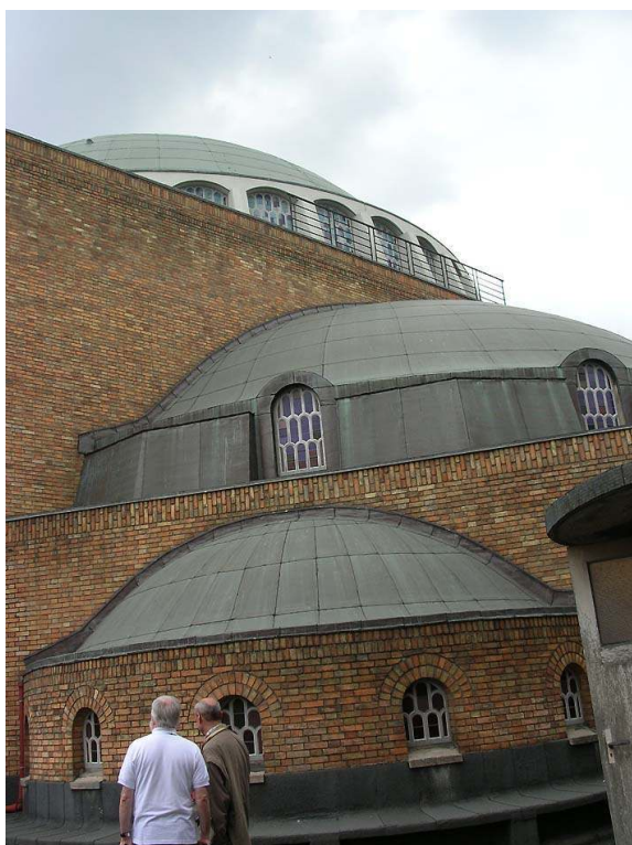
Église Saint-Esprit (12 e arr.) Toiture recouverte de paxalu « cuivre ». Phot. Laurence Fouqueray. © Mairie de Paris - DAC.
