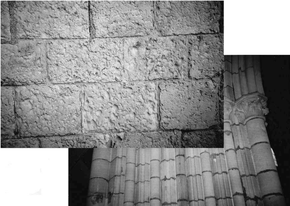
Photo XXVI : Cathédrale de Saint-Pol-de-Léon (Finistère) : pilier de la nef en calcaire de Caen et le même calcaire en extérieur, soumis à l'érosion météorique.
