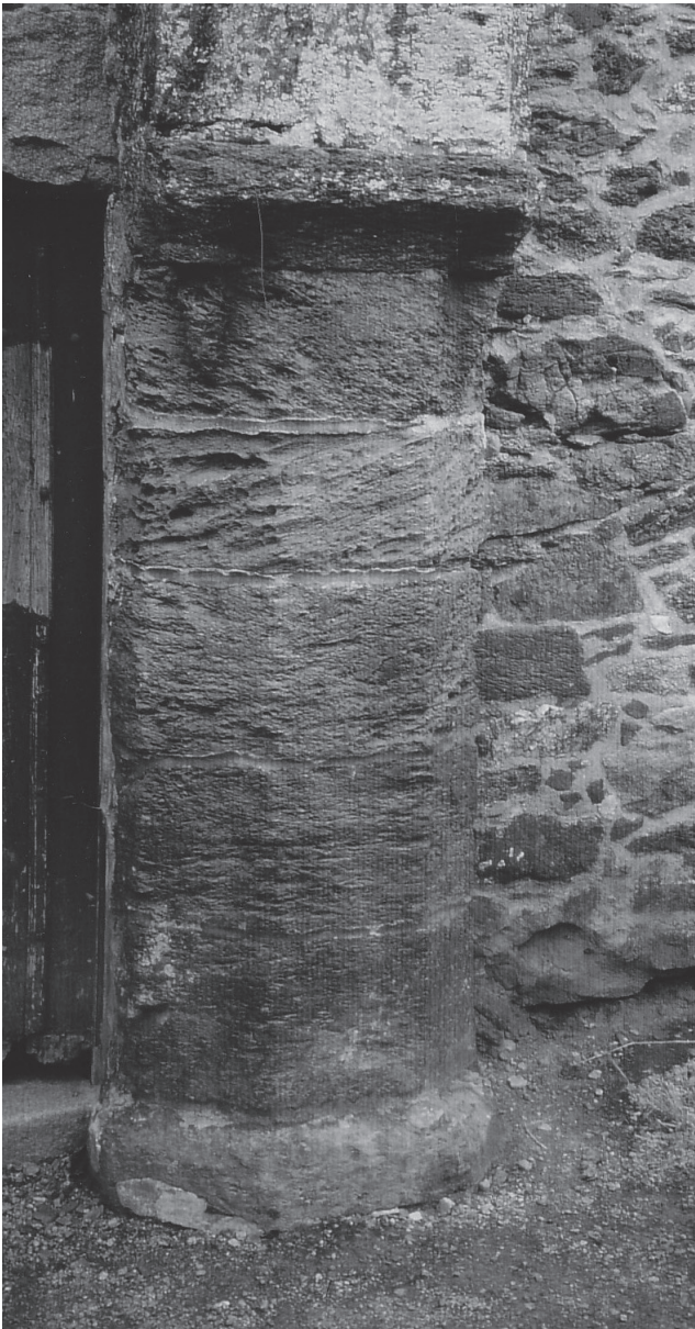
Photo VII : Vieille église de Paimpol (Côtes-d'Armor) : pilier en spilite dont la texture est soulignée par la corrosion. Photo VII: Old church of Paimpol (Côtes-d'Armor): spilite pillar with texture underlined by corrosion.
