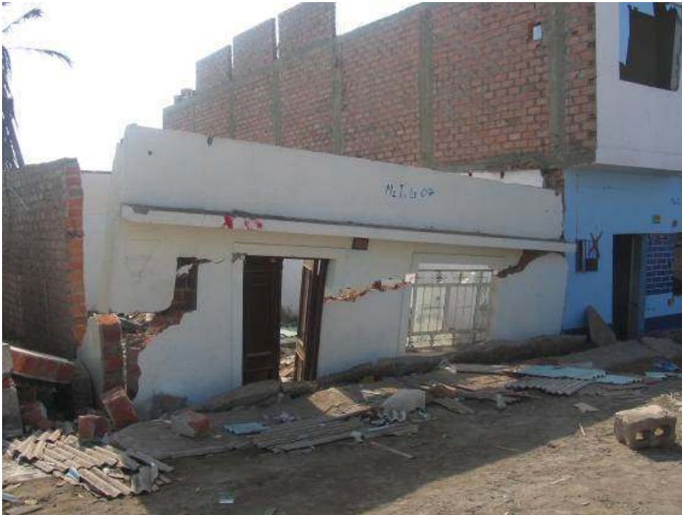
Photo 8 - Effets du phénomène de liquéfaction du sol sur une maison de Tambo de Mora (province de Chincha)
