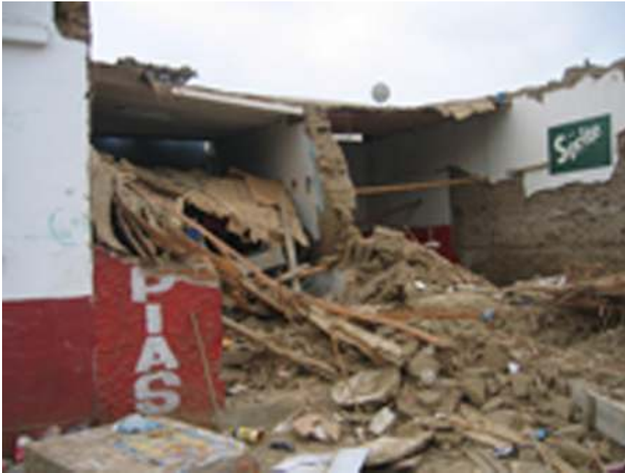
Photo 5 - Destruction d'une maison en adobe à Chincha Alta
