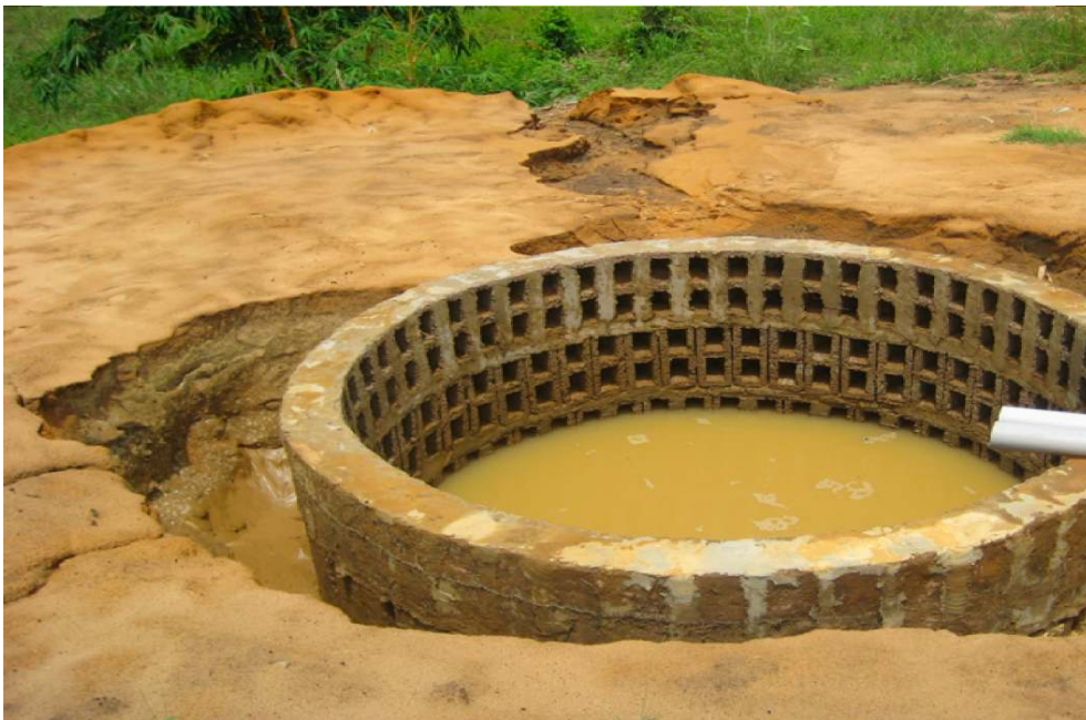
Figure 7. Rupture d'un puits perdu ayant engendré en contrebas la formation d'un ravin.
