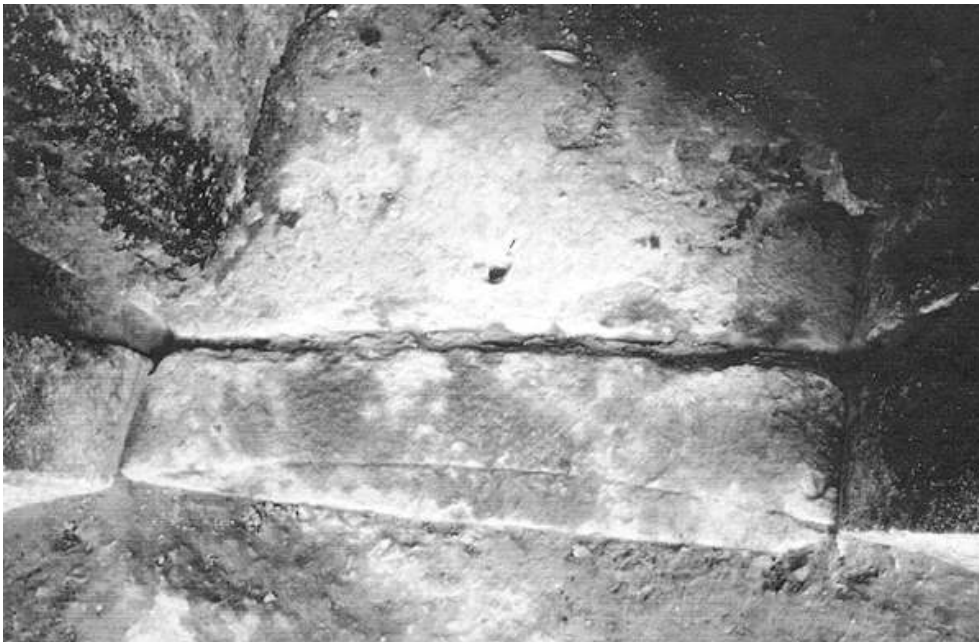
Fig. n°3 : Scellement au plomb de la demi-vanne fixe et fraction du canevas du bassin
