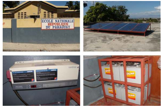
Figure 4. Installation d'électrification solaire-pilote à l'école Nationale de la République du Paraguay
