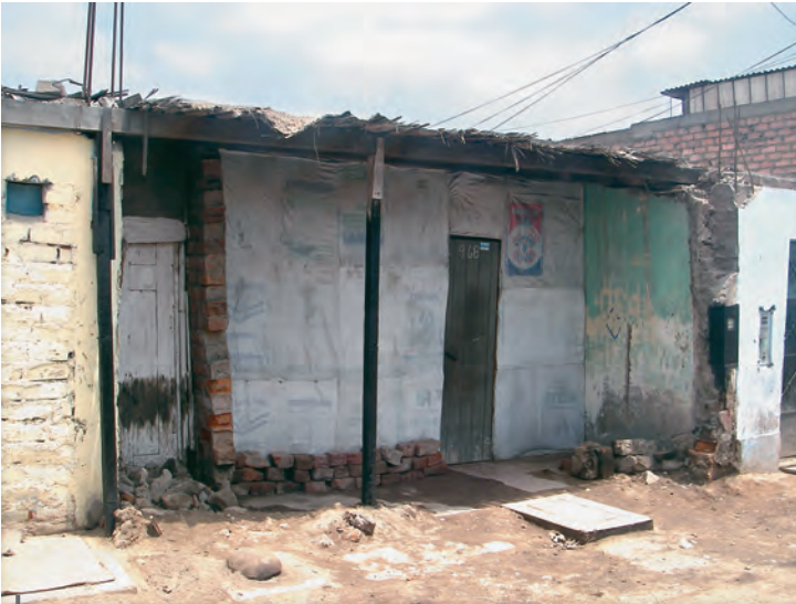
Figura 4 – Casa dañada en el barrio de Villa María del Perpetuo Socorro: la pared de la fachada, actualmente hecha de bolsas de yute, se desplomó tras el sismo de 2007
