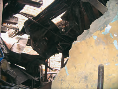
Figuras 2 y 3 – Habitante del barrio 1° de Mayo mostrando los daños en su vivienda y en particular el techo destruido. Un mes después del sismo, esta persona continuaba ocupando su vivienda durante el día. En la noche, unos vecinos la albergaban
