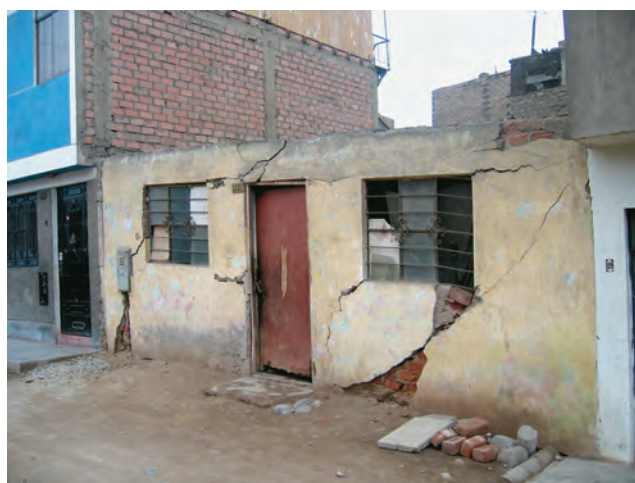
Figura 1 – Casa muy dañada en el barrio 1° de Mayo
