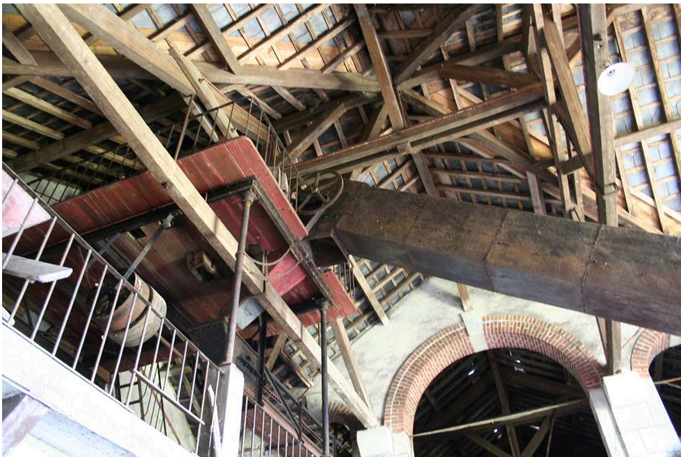
Cellier du château de Continvoir (Indre-et-Loire) : élévateur à vendange. Phot. Beschi, Alain. © Région Aquitaine, Inventaire général, 2008.
