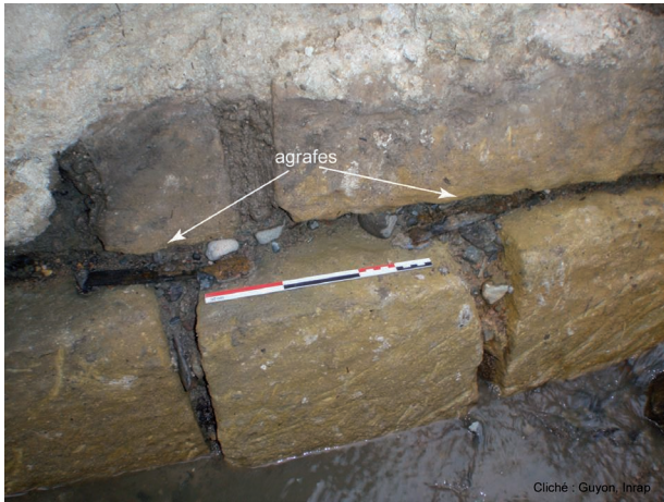
Fig. 40 : Agrafes d'assemblage des blocs en fondation du piédroit sud de la pile P4 (cliché : Guyon, Inrap).
