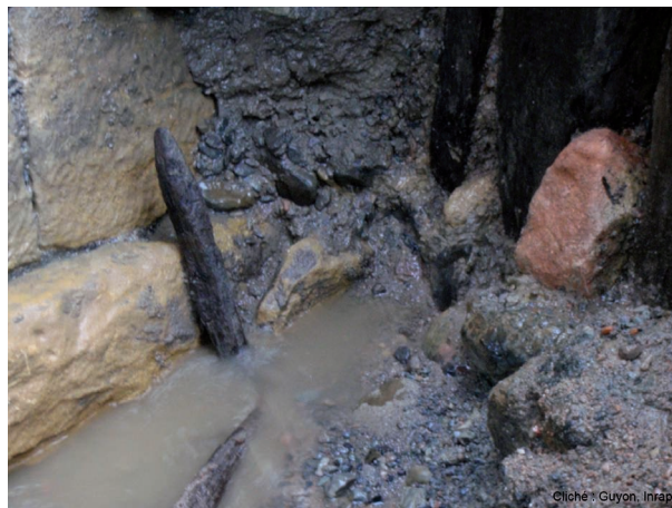
Fig. 45 : Pieu du batardeau de la pile P4 au niveau de l'avant-bec (cliché : Guyon, Inrap).
