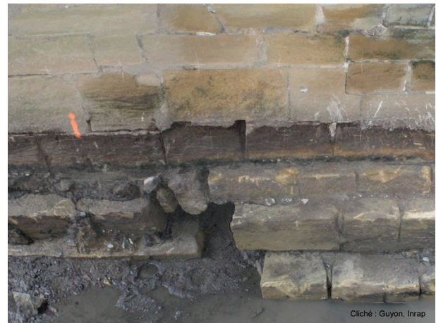
Fig. 43 : Rupture de fondation du piédroit nord de la pile P4 (cliché : Guyon, Inrap).
