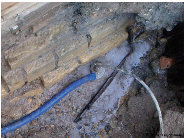
Fig. 44 : Planche inférieure du batardeau de la pile P4 au niveau de l'avant-bec (cliché : Guyon, Inrap).
