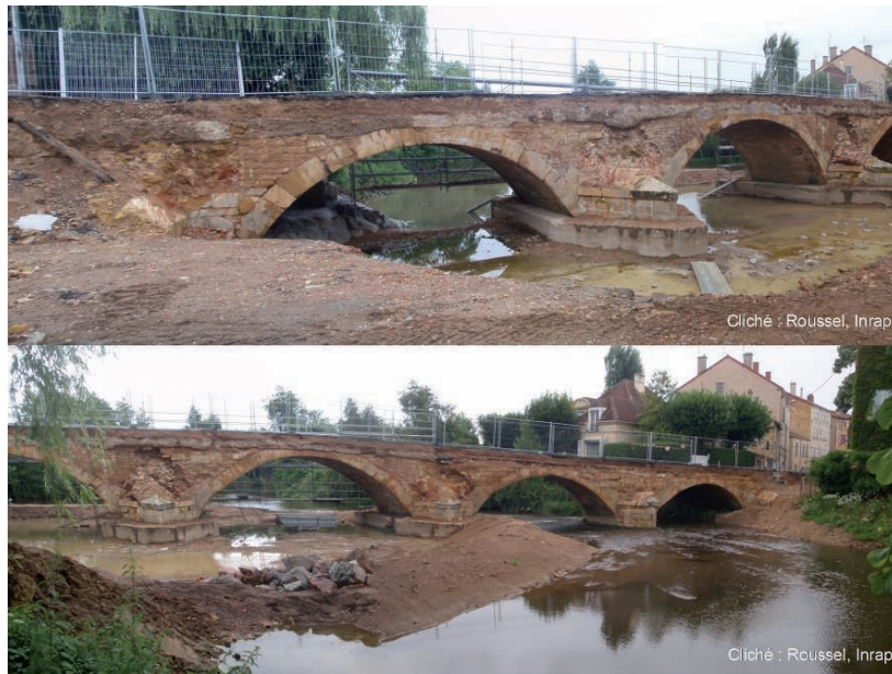
Fig. 4 : Façade amont du pont primitif avant la réfection du parement, vue depuis la rive gauche (cliché : Roussel, Inrap).
