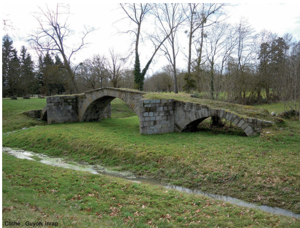
Fig. 49 : Pont de la Valla du xv e s., à Pommier (42) sur l'Aix (cliché : Guyon, Inrap).
