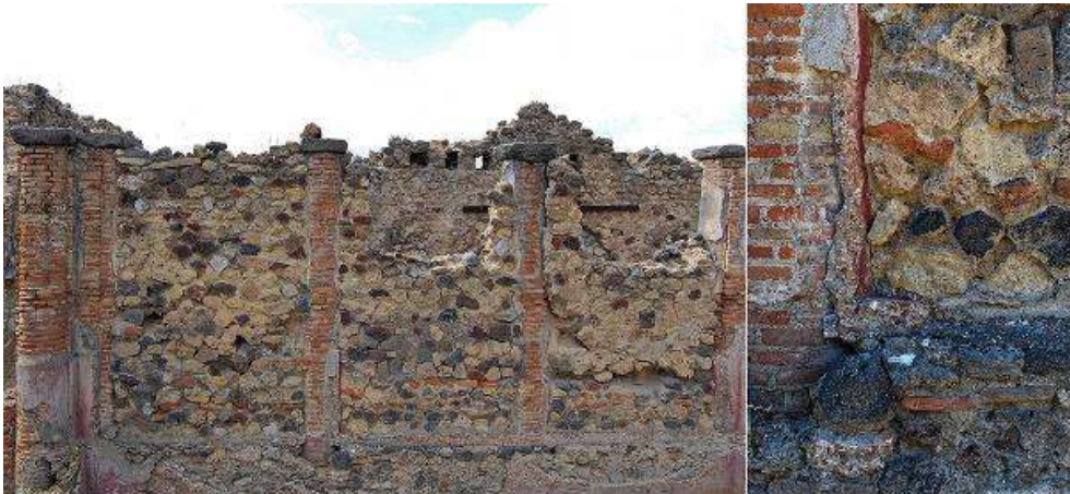
Fig. 28 – Pompéi, boulangerie VII 2, 3.6 – Vue générale du bouchage de l'entrecolonnement du bras septentrional du péristyle.
