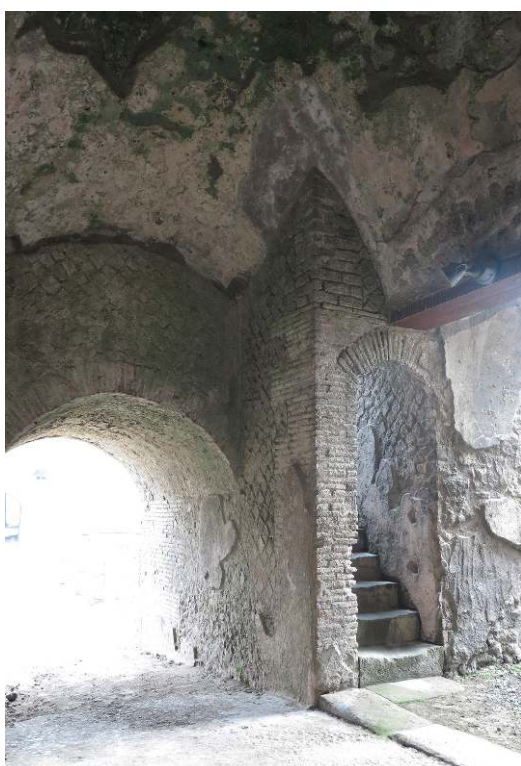
Fig. 13 – Aménagement en sous-œuvre de l'accès à la tribune et du débouché dans l' orchestra .
