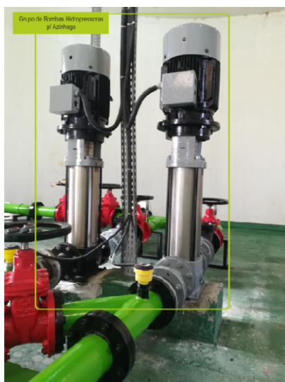
Figura 4-3: Bombas Hidropressoras para a Azinhaga
