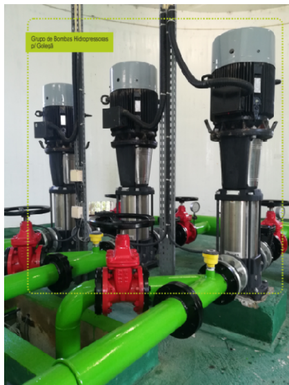
Figura 4-2: Bombas Hidropressoras para a Golegã
