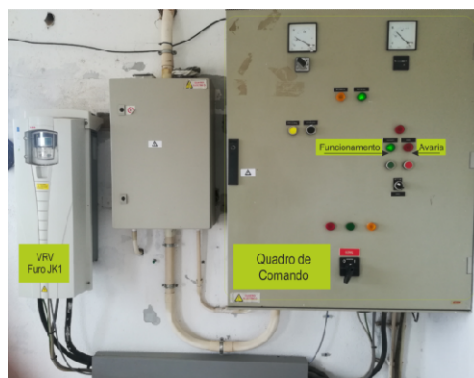
Figura 4-10: Quadro de Comando Furo JK1 e Variado de Velocidade
