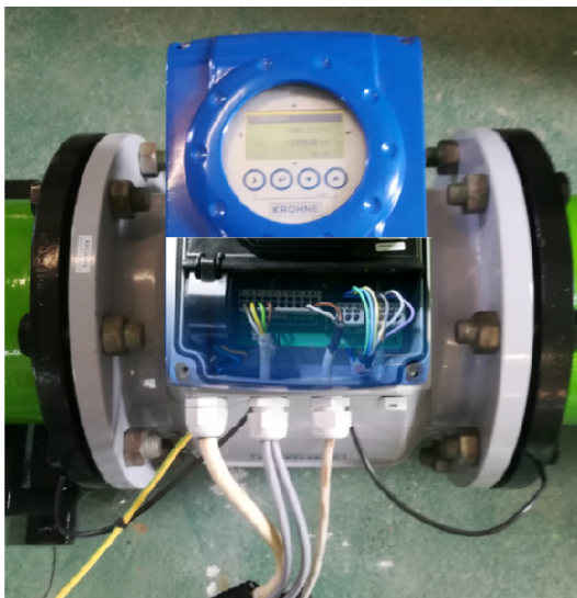
Figura 4-6: Caudalímetro, saída ModBus e Analógica 4-20mA
