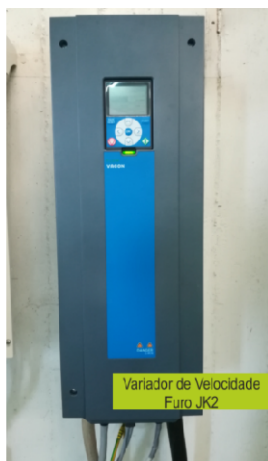
Figura 4-4: Variador de Velocidade Furo JK2, saída ModBus
