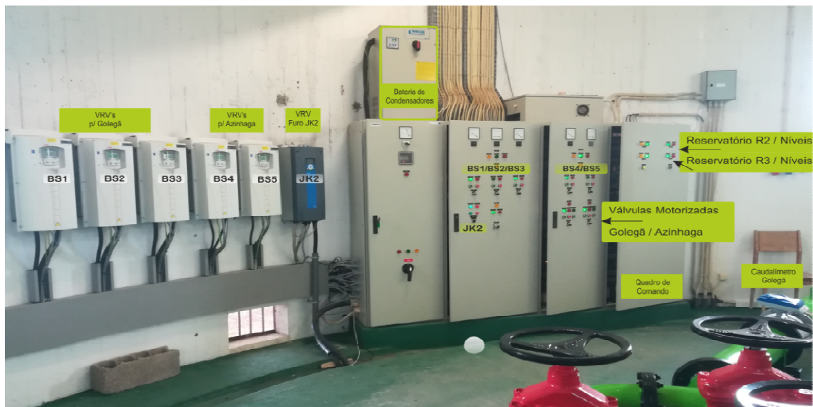
Figura 3-3: Equipamentos instalados na ETA da Broa
