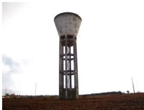
Figura 3-11: Reservatório de Azinhaga
