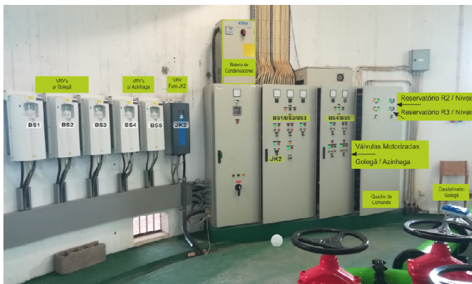
Figura 4-1: Quadro de Comando ETA da Broa e Variadores de Velocidade
