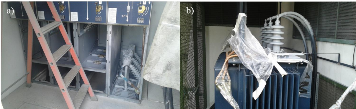
Figura 6.2 – a) Celas, b) transformador de potência depois da aplicação do Si-COAT 570.
