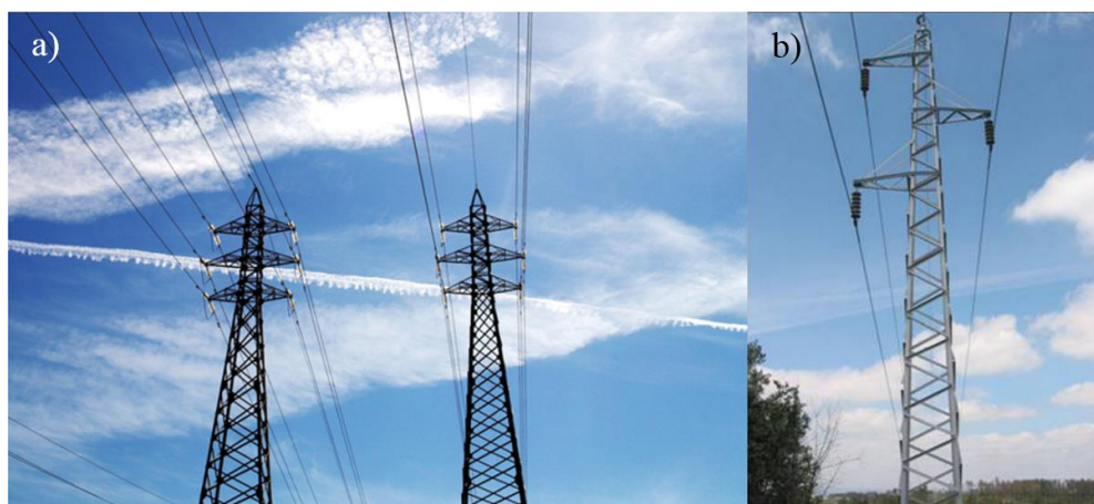
Figura 3.11 – a) Linhas de MT com dois circuitos trifásicos, b) linha de MT com um circuito trifásico [20].
