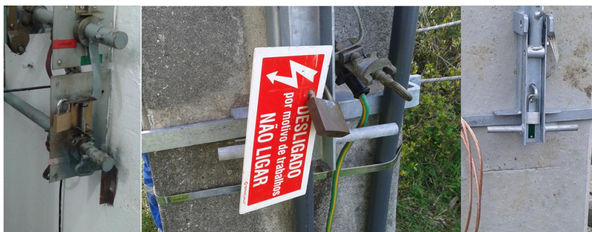
Figura 4.13 – Bloqueio do manípulo de comando do seccionador do transformador.
