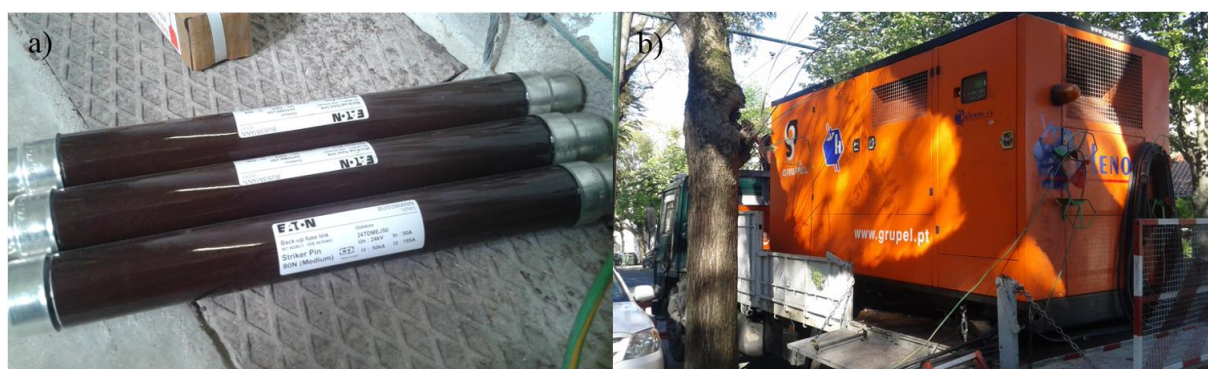
Figura 6.14 – a) Fusíveis HH utilizados, b) gerador em local de obra.
