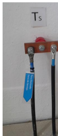
Figura 5.10 – Barramento de terra de serviço (TS).
