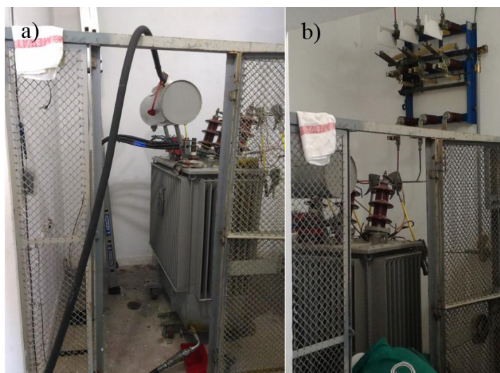
Figura 6.4 – a) Entrada e saída do óleo isolante do transformador de potência, b) interruptor seccionador-fusível desligado.
