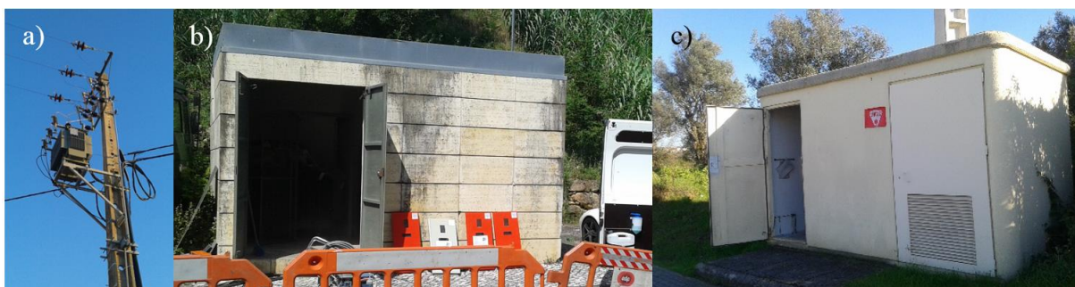
Figura 5.1 – a) Modo de construção em poste, b) modo de construção em cabine baixa, c) modo de construção em monobloco de PT's.
