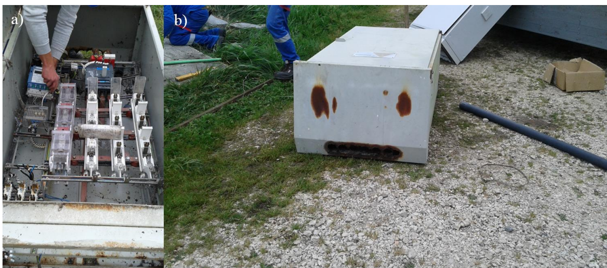
Figura 6.18 – a) Interior do armário do QGBT existente com elevada corrosão, b) exterior do armário do QGBT existente.
