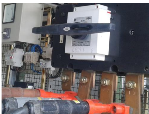
Figura 3.15 – Barramentos com identificação de fases e do neutro.
