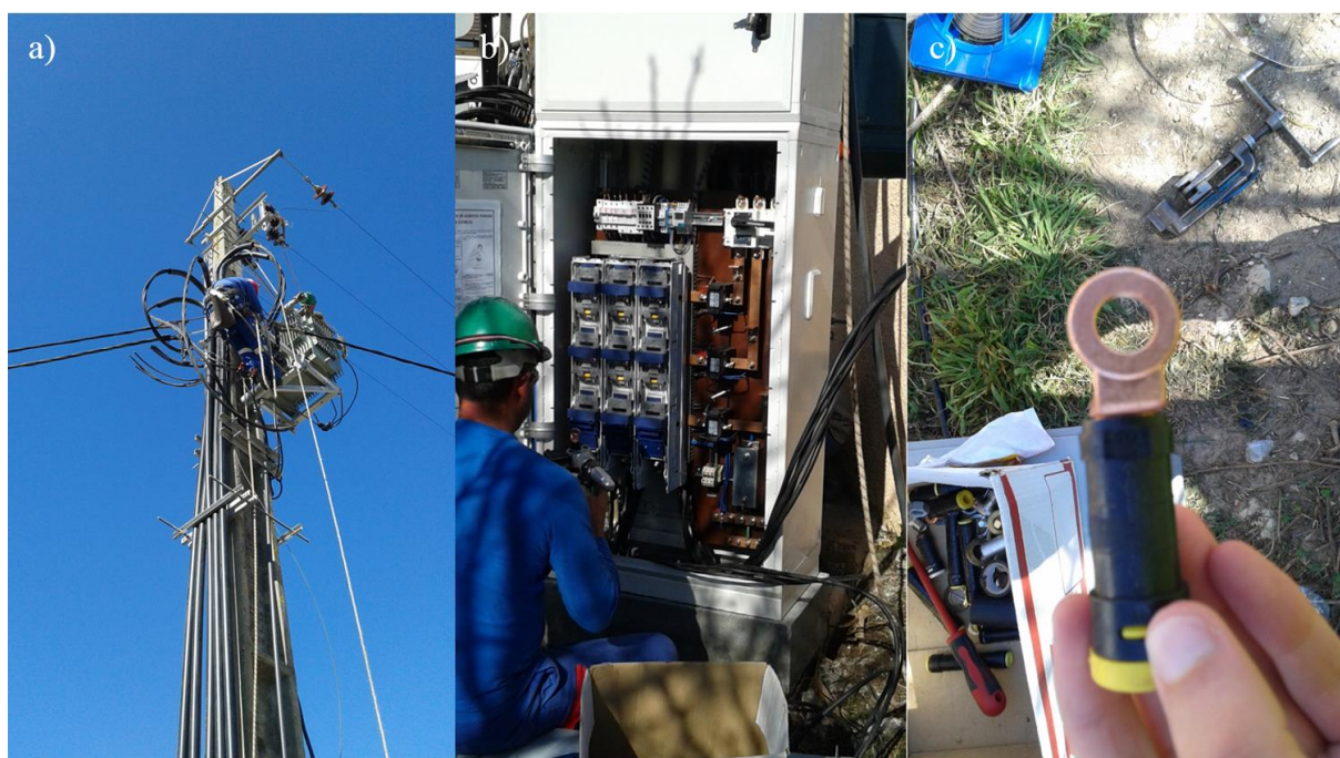
Figura 6.15 – a) Ligações do transformador de potência ao QGBT, b) ligações no QGBT, c) terminal bimetálico.
