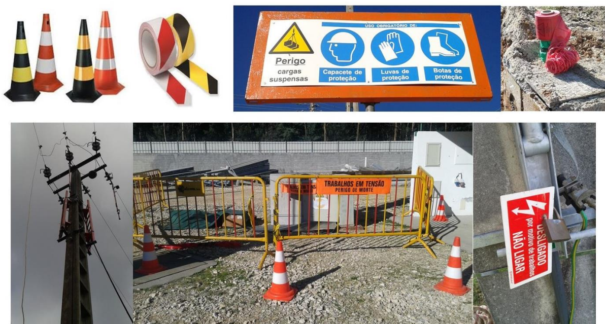
Figura 4.15 – Exemplificação de variados Equipamentos de Proteção Coletiva.
