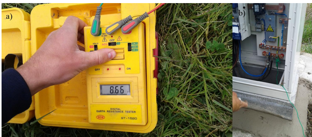
Figura 6.19 – a) Medição da resistência de contacto do elétrodo de terra de proteção, b) ligação do medidor de terras ao elétrodo de terra sob teste no QGBT.
