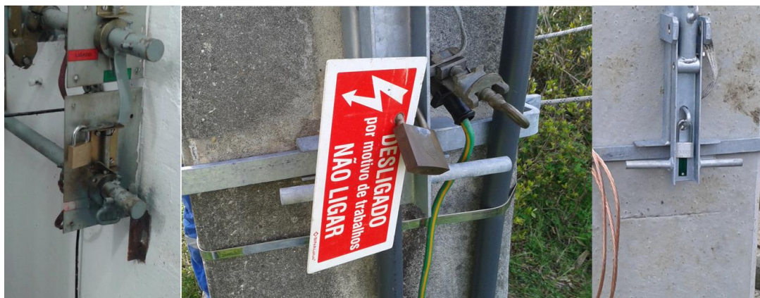
Figura 4.21 – Bloqueio de aparelhos de corte na rede.
