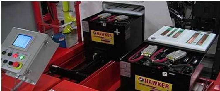
Figura 3.16 - Troca de baterias automática
