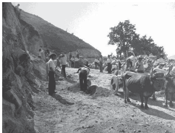
Figura 3. Estrada de acesso à central de Venda Nova, 1947 – Fotografia Alvão, Arquivo Fotográfico da EDP, Porto.
