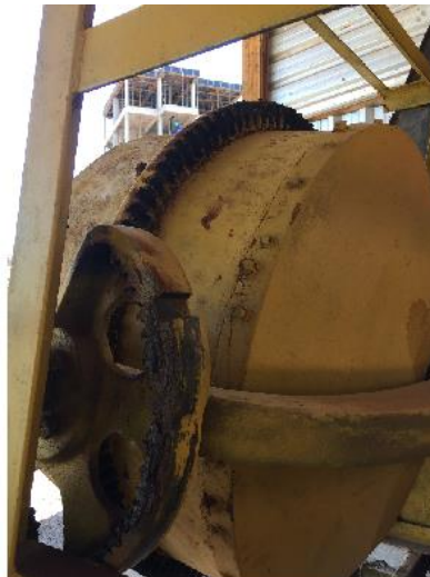
Figura 24 - Obra A: Betoneira sem protetor dos “dentes”
