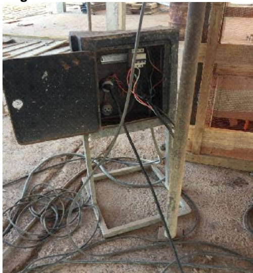
Figura 20 - Obra A: Quadro de Tomada
