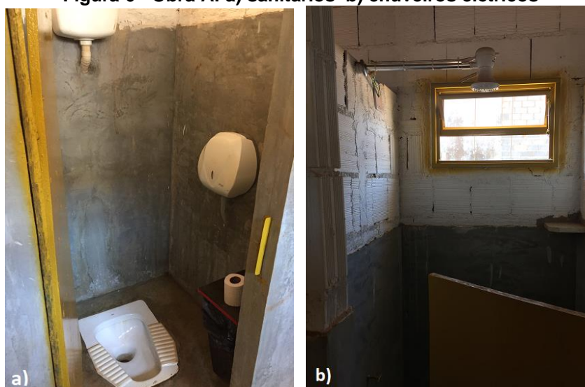
Figura 6 - Obra A: a) sanitários b) chuveiros elétricos
