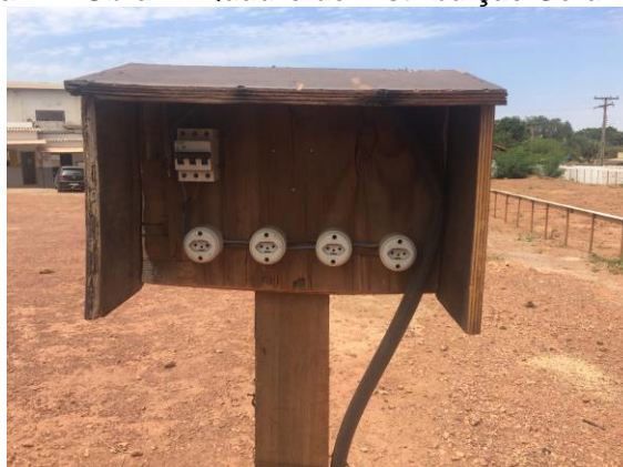
Figura 21 - Obra A: Quadro de Distribuição Geral
