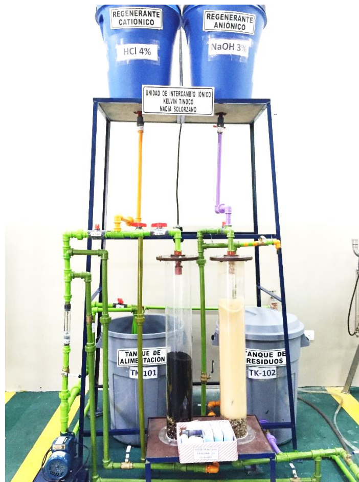
Figura 14. Unidad de Intercambio Iónico construido, listo para ser puesto en marcha.
