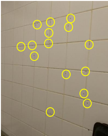
Figura 3.12: Não- conformidades no Controlo de Pragas.
