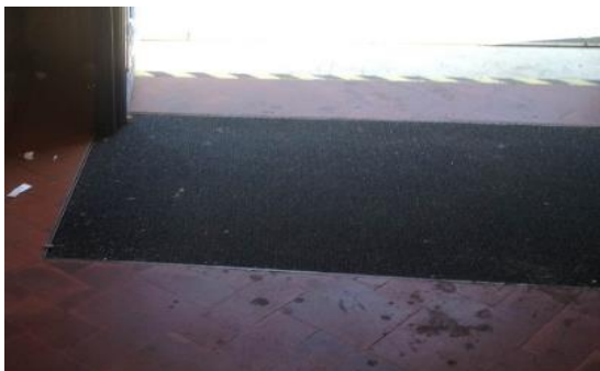
Figura 3.14: Não- conformidades na Recepção. Falta de manutenção e higiene na zona de receção de matérias-primas (confeitaria).
