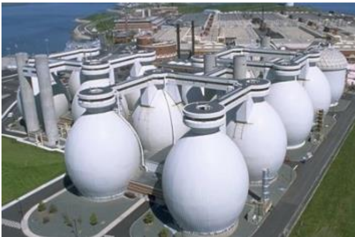
Figura 17. Digestores de lodo.
