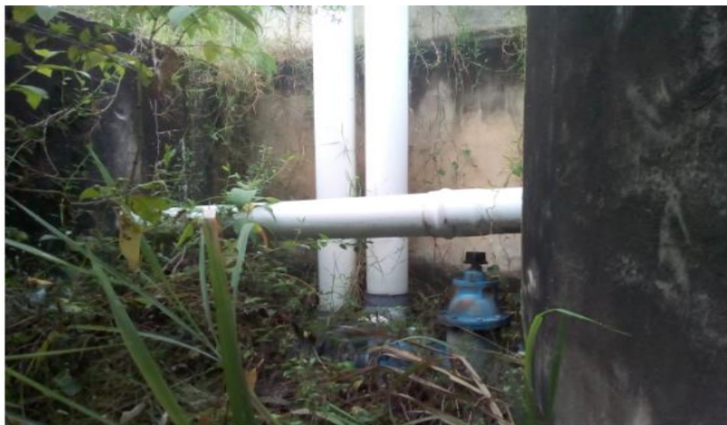
Figura 11. Sistema de tuberías y válvulas de digestores. Tomado de: PTAR Arbeláez.
