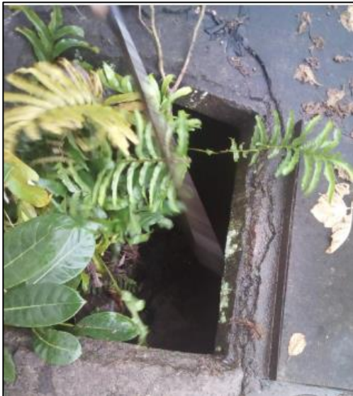
Figura 4. Cámara de alivio. Registro tomado el 14 de marzo de 2019. PTAR Arbeláez.
