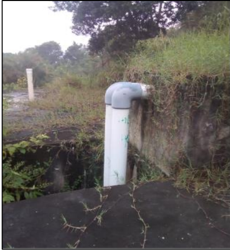
Figura 12. Ingreso tuberías a digestor
