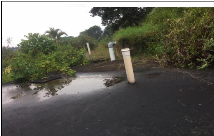
Figura 9. Salida de Biogás del digestor anaerobio. PTAR Arbeláez.
