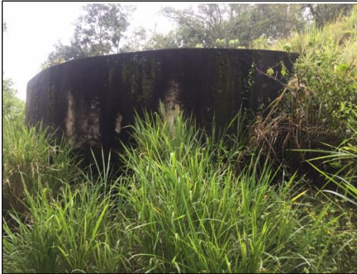
Figura 10. Digestor Anaerobio. PTAR Arbeláez.
