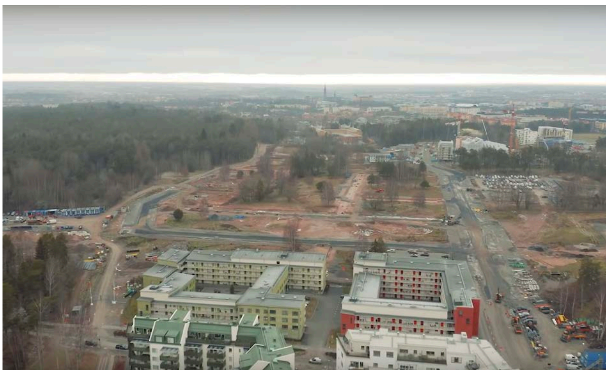
Bild 31. Flygvy över området för den nya hållbara stadsdelen Rosendal i Uppsala. Källa: Uppsala kommun 2019
