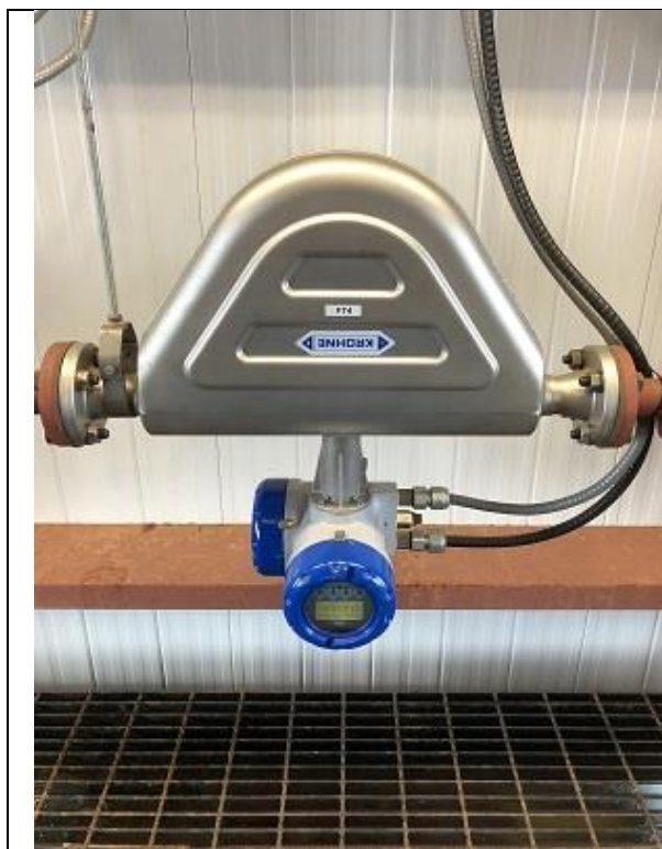
FT4 – Coriolis meter
