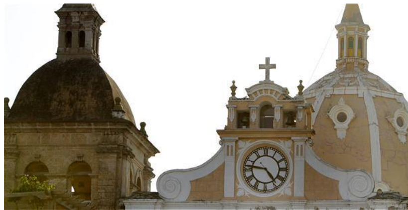
Ilustración 7: Cúpula de San Pedro en Cartagena deteriorada
