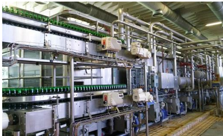
Figura 11 – Pasteurizador da linha 6
