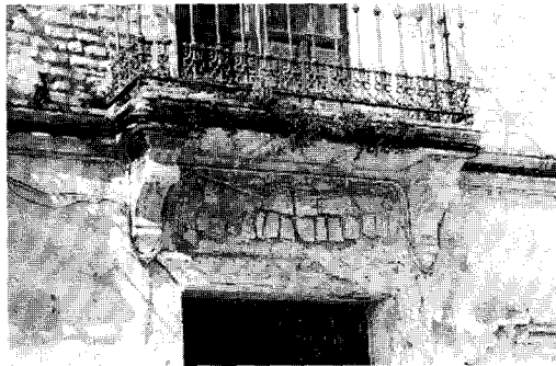
Figura 5 Detalle de las piedras sin trabazón en cargadero
