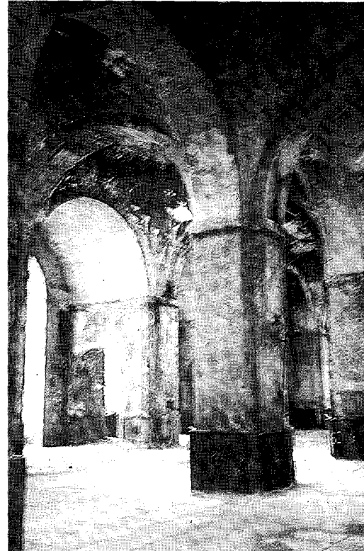
Figura 1 Soporte de la nave denominada La Catedral en la Fundición de Artillería de Sevilla
