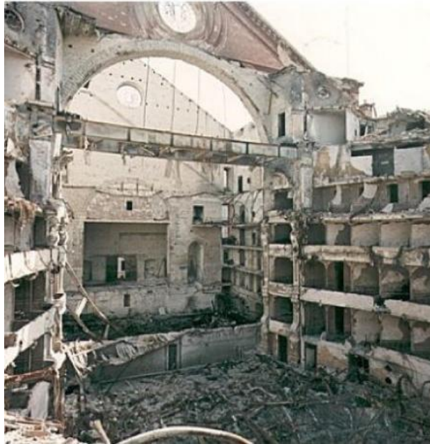
Figure 1.13 The consequences of the devastating fire inside the theater. Ref; Mario Panizza, "Edifici per lo spettacolo", Laterza, Bari, 1996
