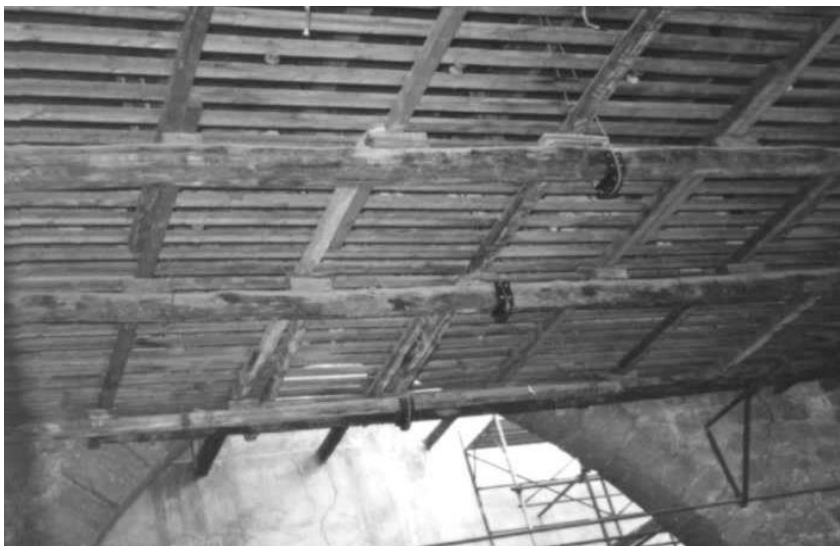
Figure 2. 10 Garibaldi theatre in Palermo – the trellis on the stage. Ref; Calogero Vinci, Il teatro Garibaldi a Palermo e la costruzione dei teatri storici minori, Palermo 2013, Edizione fotograf
