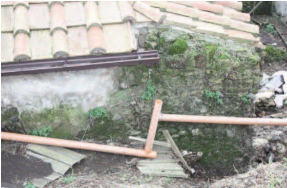
Fig. 6. Casa di Trebio Valente, Pompei (2010). Il distacco dei pluviali comporta accumuli di acqua nel terreno e umidità di risalita capillare. L'intervento manutentivo richiesto non presuppone conoscenze tecniche elevate.
