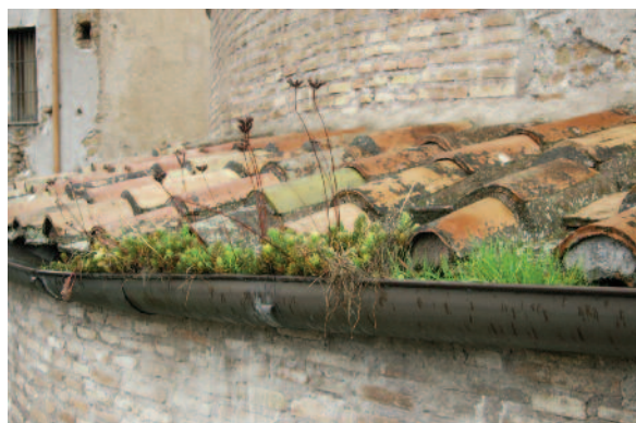
Fig. 4. Tempio di Romolo, Roma, Fori Imperiali (2010). Presenza di vegetazione nei canali di gronda dovuta a mancate manutenzioni, alla presenza di terriccio e materiali di risulta (dallo sfaldamento dei coppi) a sua volta provocato da disallineamenti dei canali e dalla formazione di ristagni di acqua.
