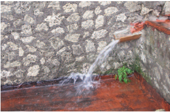
Fig. 7. Casa della Fontana Piccola, Pompei (2010). Errato sistema di convogliamento delle acque meteoriche e errori banali nell'esecuzione del manto impermeabile, in specie nei raccordi con la superficie verticale. Anche in questo caso l'intervento manutentivo richiesto non presuppone conoscenze tecniche elevate ma semplicemente l'utilizzo di pratiche consolidate e ben note nel settore.
