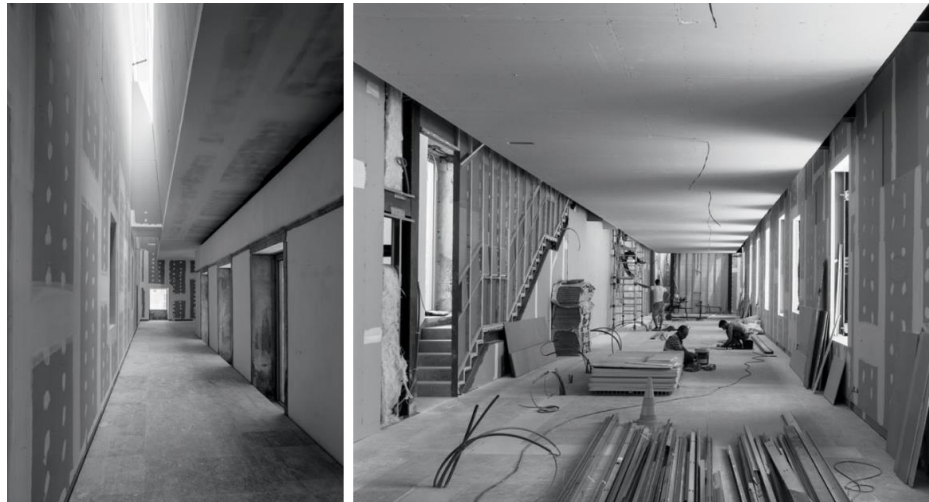
Fig. 6. Fotografías tomadas durante la fase de obra del Colégio da Trindade, Aires Mateus, 2013-2016.
